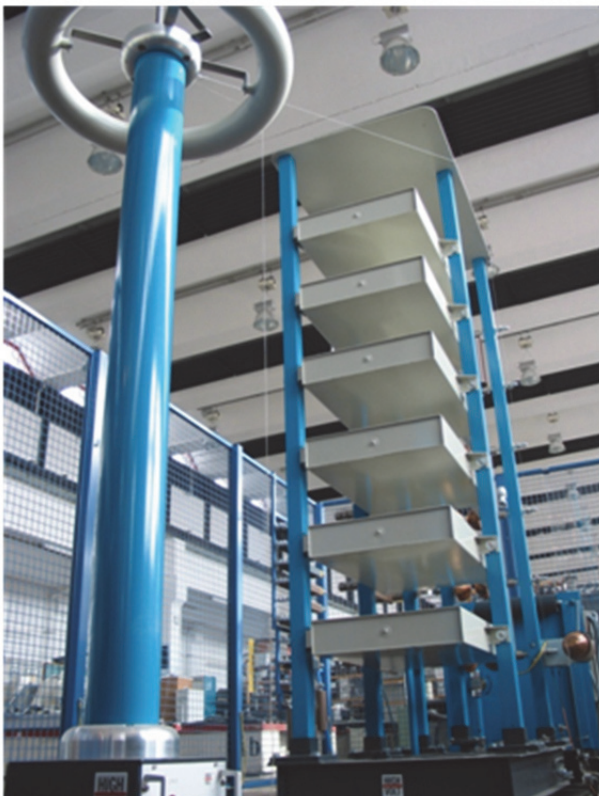
Abbildung: Stoßspannungsgenerator zur Erzeugung von Blitzstoß- und Schaltstoßspannungen bis 600 kV
