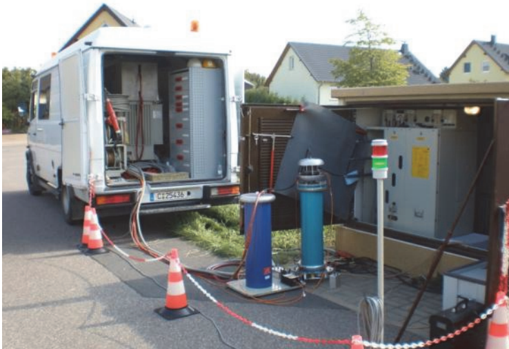
Abbildung: Mobiles Resonanzprüfsystem zur Teilentladungs- und Verlustfaktormessung und Spannungsprüfung
